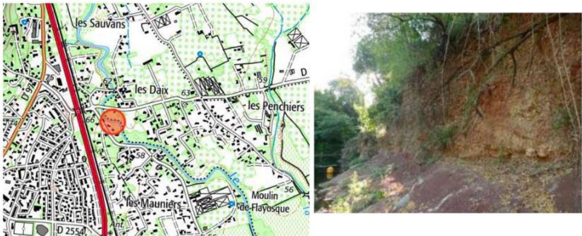
Site de recréation de berge à Solliès-Ville du fait de son érosion (source : PAPI Gapeau)
